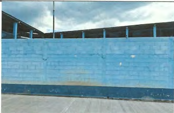
Foto 2: Muro afectado y dañado por los sismos, lado frontal.
